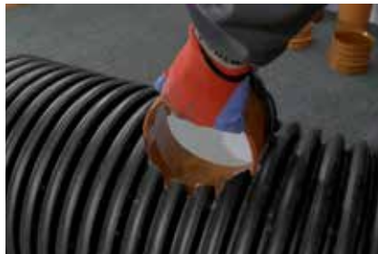
7. Ubacivanje tela saga kroz unapred pripremljeni otvor i postavljanje u odgovarajuću poziciju
